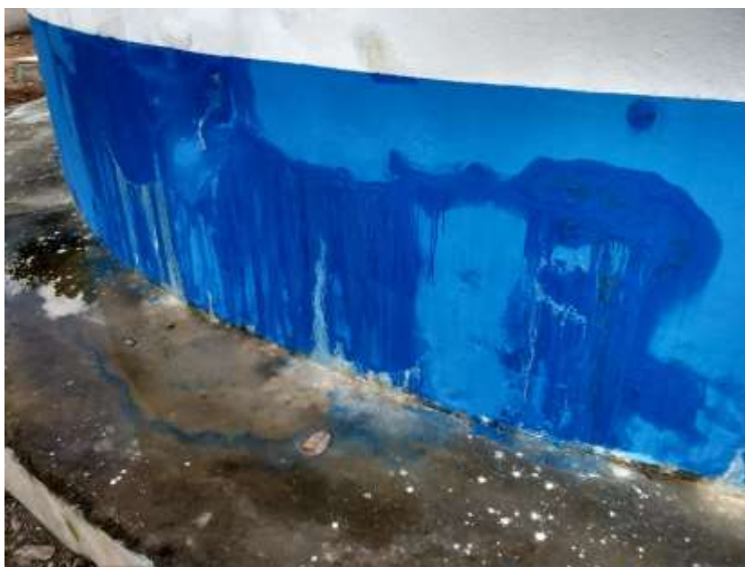
FOTO 1 – VAZAMENTOS NO RESERVATÓRIO APOIADO.
