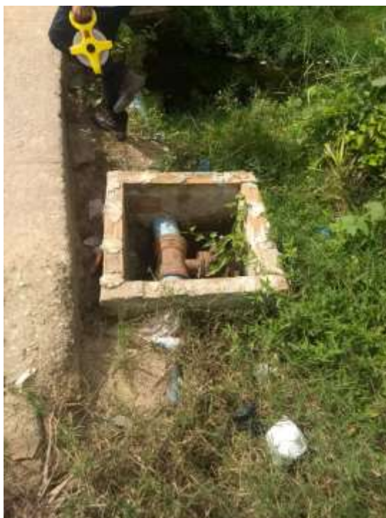
FOTO 7 – CAIXAS DE DESCARGAS E VENTOSAS REVESTIMENTOS E TAMPA.
