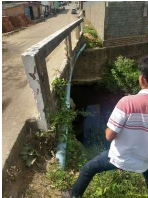
FOTO 5 – ENCURVADURA E MATERIAL DEFOFO EXPOSTO.
