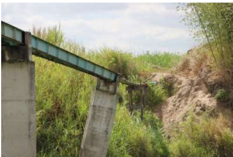
Figura 3 – Deslocamento do apoio na calha lateral do rio Paraíba
