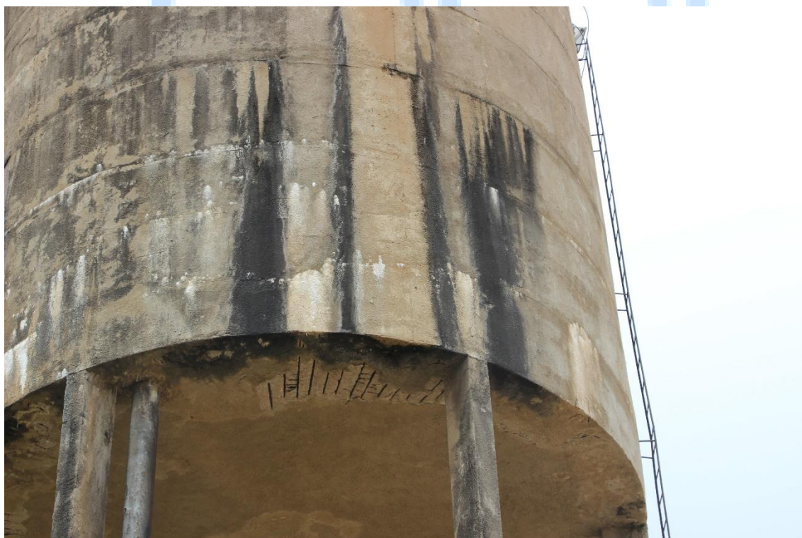
Figura 5. Exposição da armadura na laje inferior do reservatório
