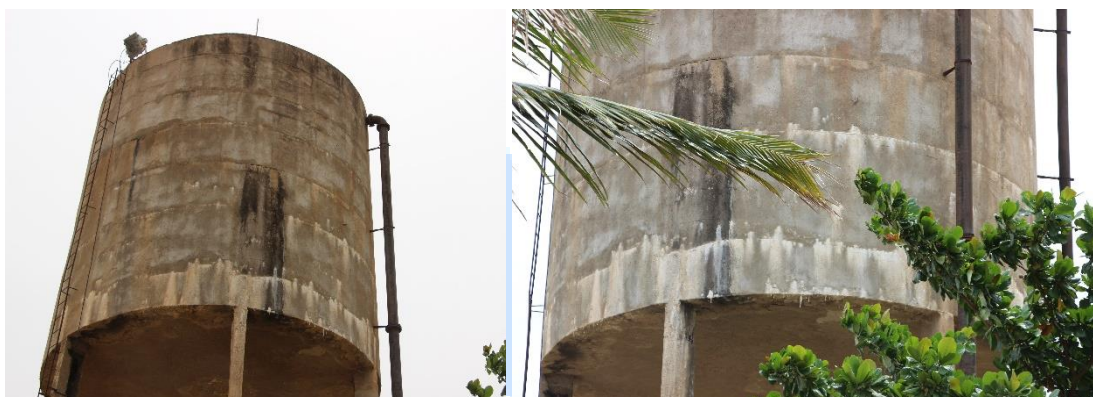
Figura 6. Fissuras nas paredes com vazamentos
