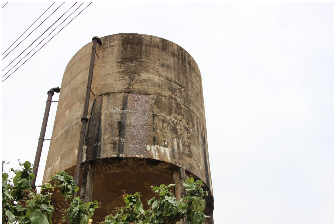
Figura 4. Deslocamento de concreto
