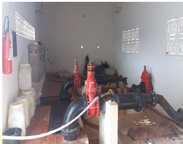
Figura 2: Conjunto Moto Bomba Submerso Poço das Trincheiras.
