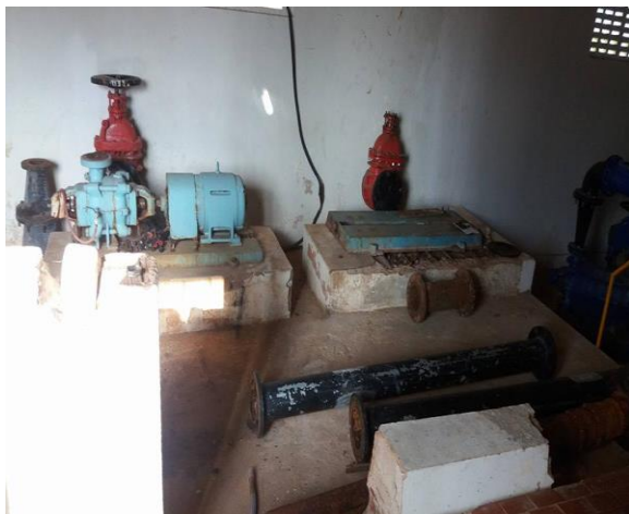
Figura1: Conjunto Moto Bomba, desativado, da Adutora Velha – Santana – Dois Riachos.
