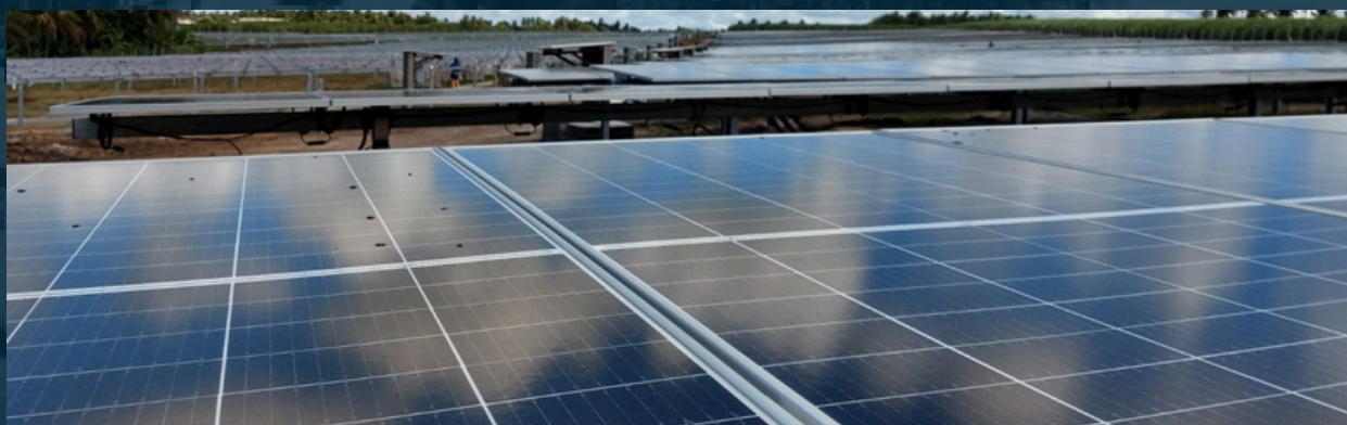
Foto: Placas Fotovoltaicas Miniusina- Coruripe-AL (acervo Casal)
