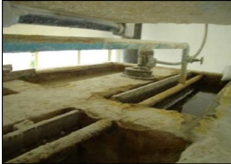
Foto 3: Aspecto de um dosador de produto químico a ser recuperado
