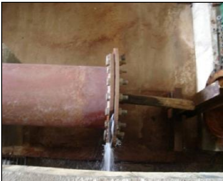
Foto 5: Necessidade de instalação de flange de aço no barrilete de recalque da EEAT-2
