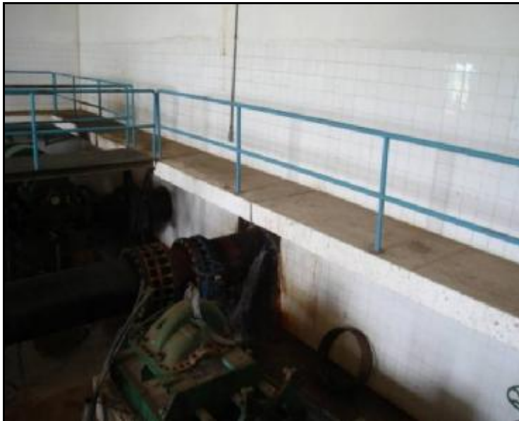
Foto 4: Recuperação estrutural na parede do poço de sucção da EEAT-2, onde pode ser observado vazamento no ponto de engaste do barrilete de sucção
