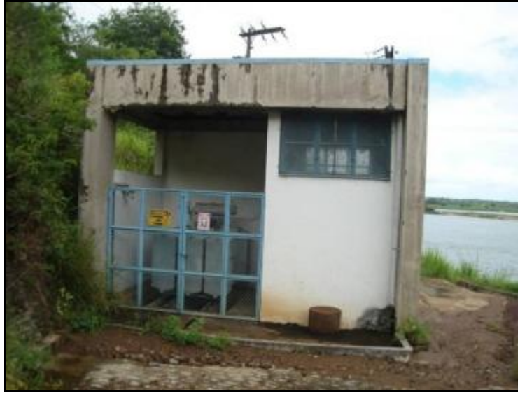
Foto 2: Necessária substituição do óleo e revisão do transformador de 1.000 KVA
