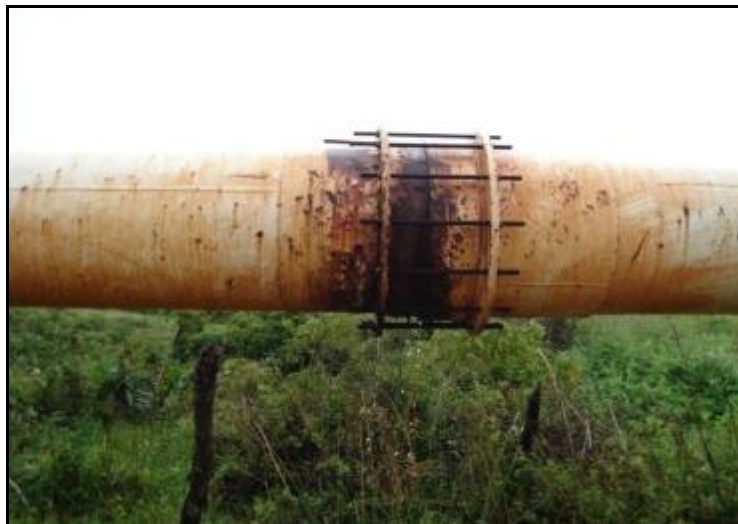
Foto 7: Travessia aérea da adutora em aço carbono, destacando-se o comprometimento do revestimento externo, além de vazamento na junta de dilatação
