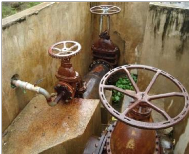
Foto 9: Aspecto atual das válvulas de controle e interligação do Centro de reservação de Campo Grande
