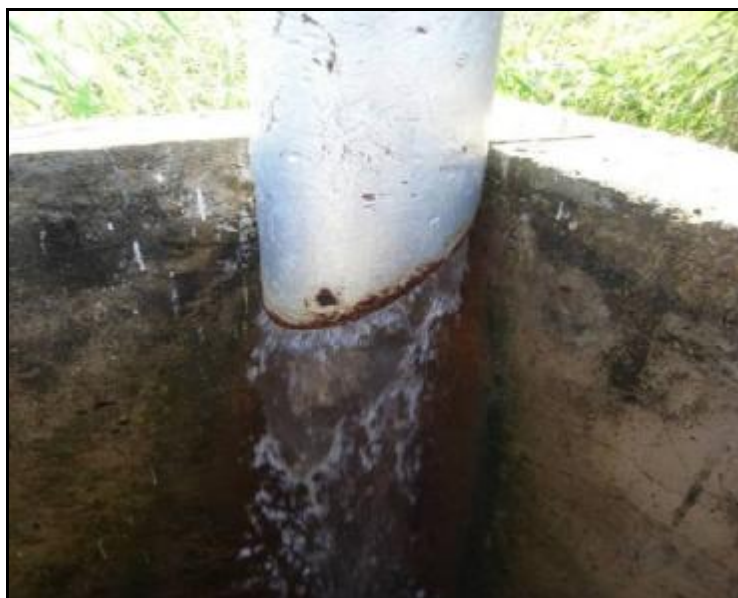
Foto 6: Vazamento permanente no tanque de amortecimento por falta de vedação e atuação do registro automático
