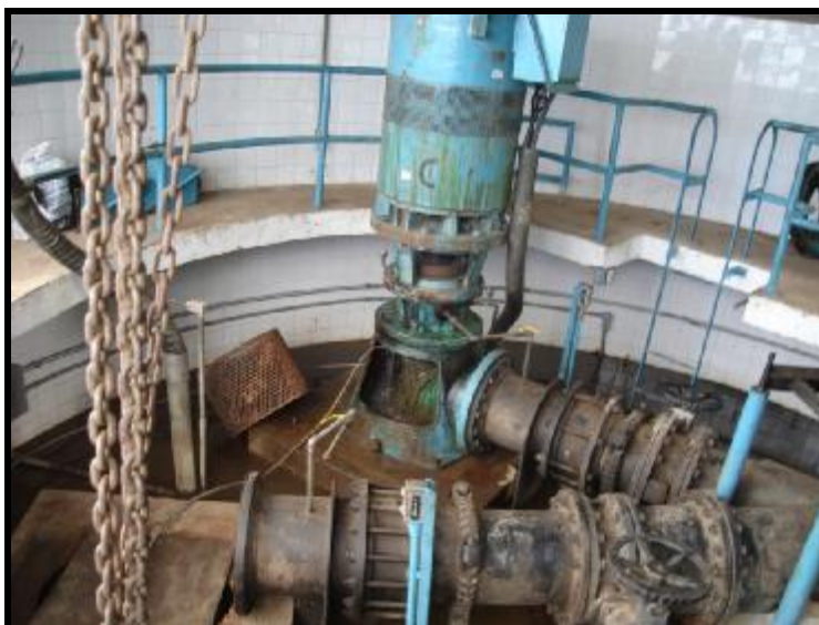
Foto 1: Ausência do conjunto moto-bomba à esquerda do barrilete de recalque na estação elevatória da captação de água bruta
