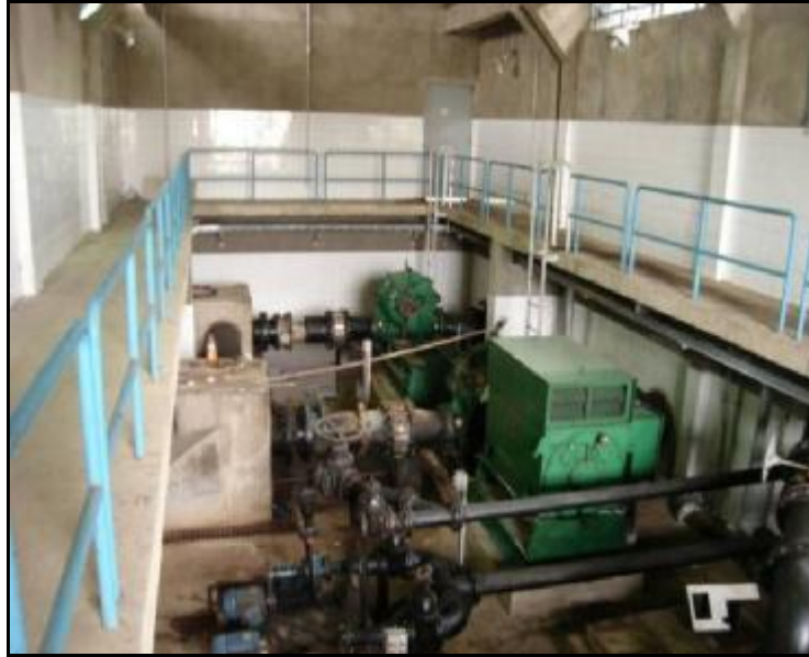
Foto 8: Estação elevatória de Campo Grande, onde os equipamentos necessitam de recuperação total, inclusive válvulas e conexões dos barriletes
