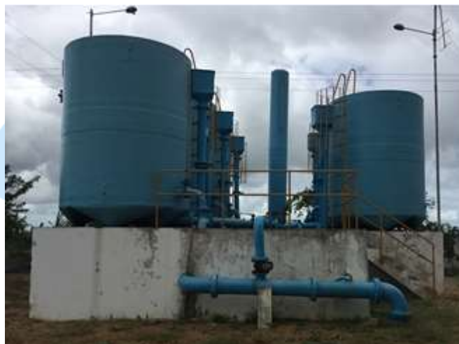
Figura 3 - Estação de Tratamento de Anadia
