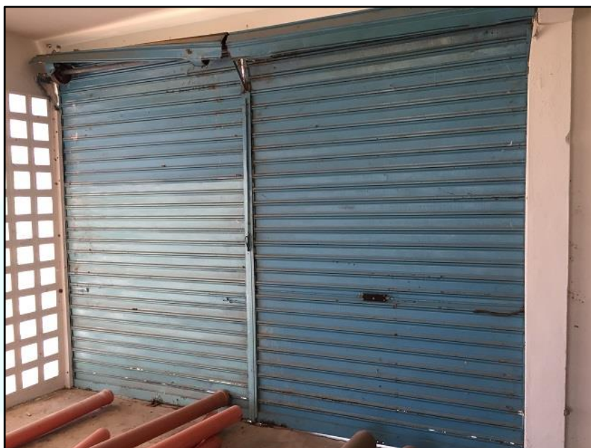
Figura 6 - Porta de enrolar fora de condições de uso.
