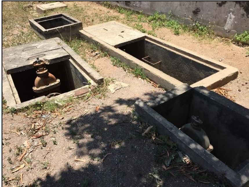
Figura 4 - Tampas de concreto quebradas.
