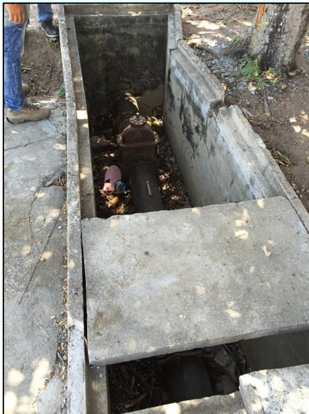
Figura 3 - Tampas de concreto quebradas.
