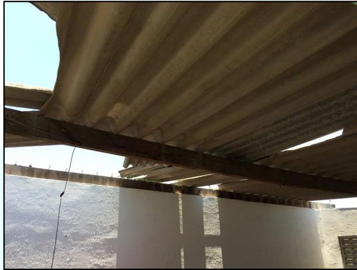
Figura 2 - Telhado da casa de bomba danificado.
