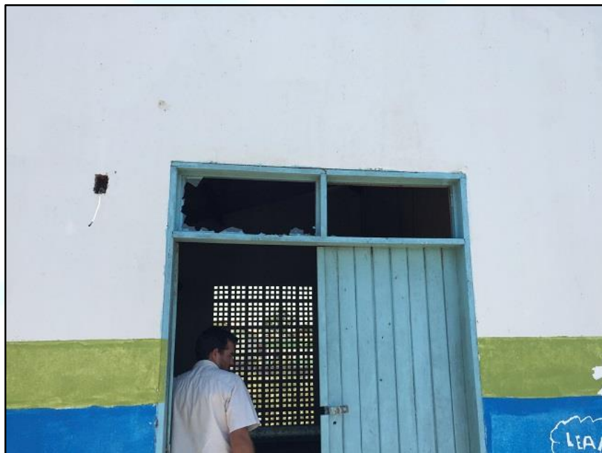
Figura 5 - Esquadrias e vidros quebrados.
