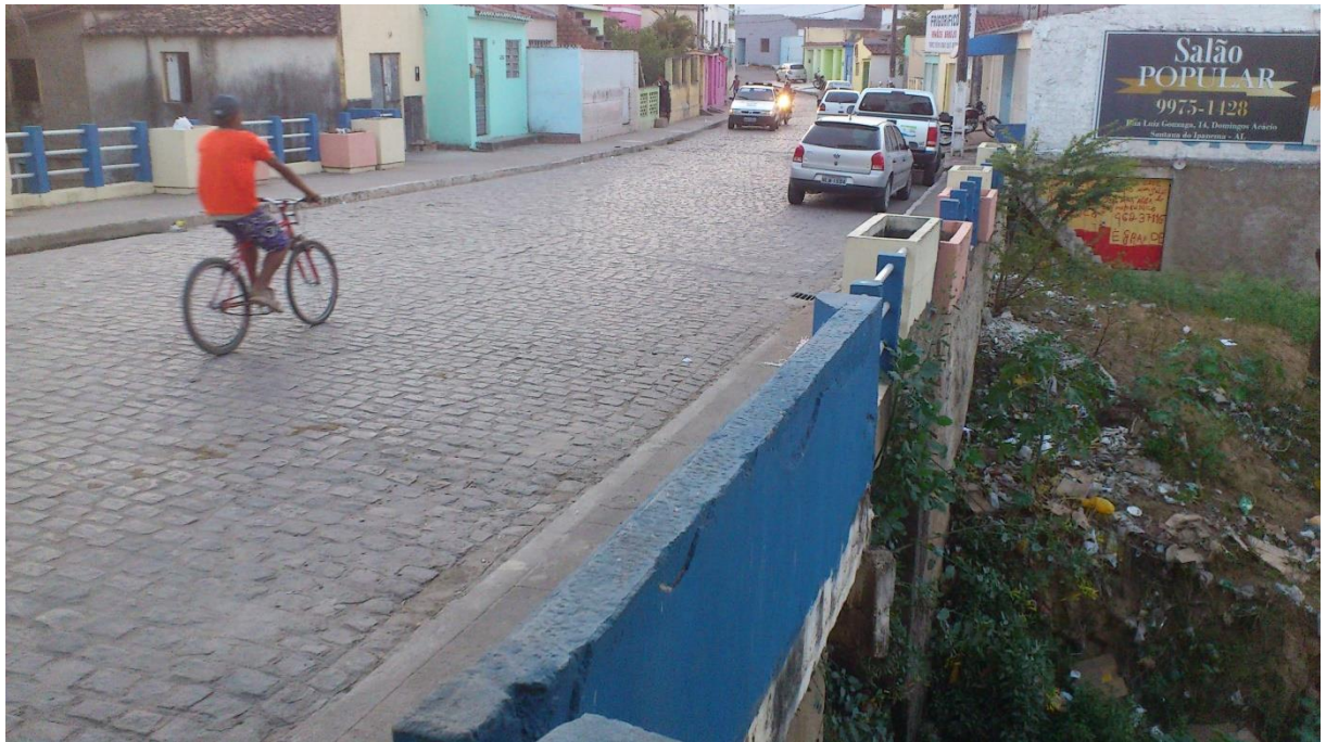
Foto 1. Ponte na rua Luiz Gonzaga – Local a ser executada a mini estação elevatória de esgoto.
