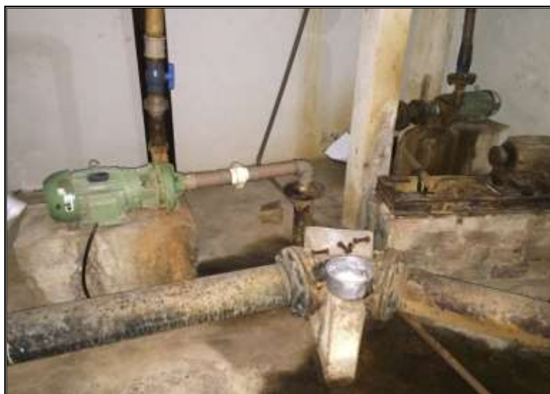
Figura 4 - Bombas da ETA de Joaquim Gomes.
