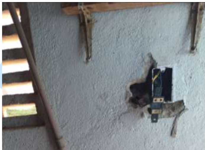
Figura 6 - Interruptor quebrado e fiação visível.
