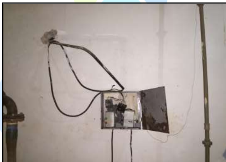
Figura 7 - Disjuntor aberto e exposto no prédio da ETA.
