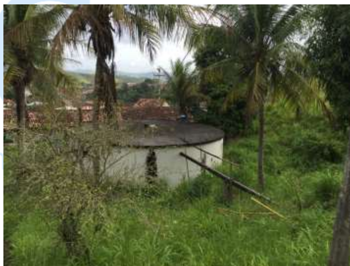
Figura 5 - Reservatório de distribuição encoberto pela vegetação ao redor.
