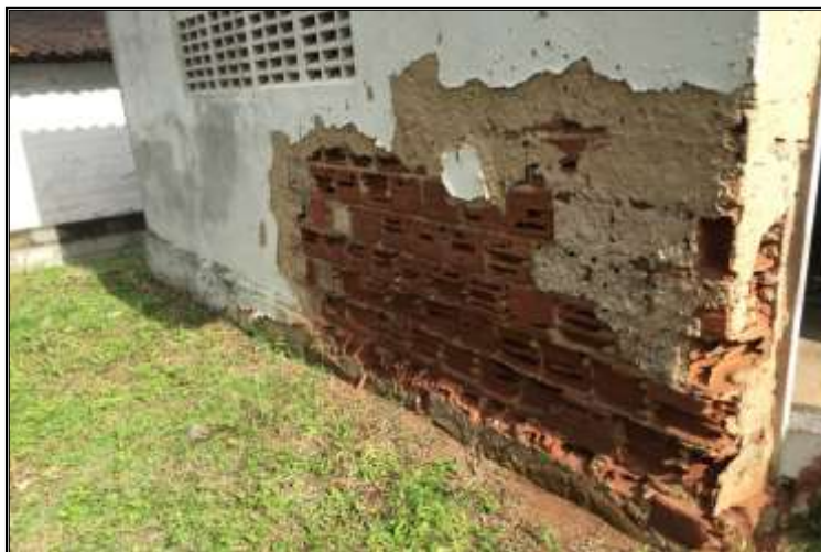
Figura 10 - Casa de química com alvenaria danificada.
