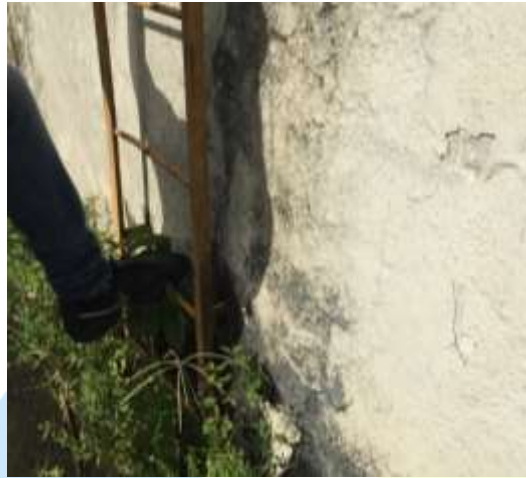
Figura 8 - Escada do reservatório elevada extremamente próxima da estrutura.
