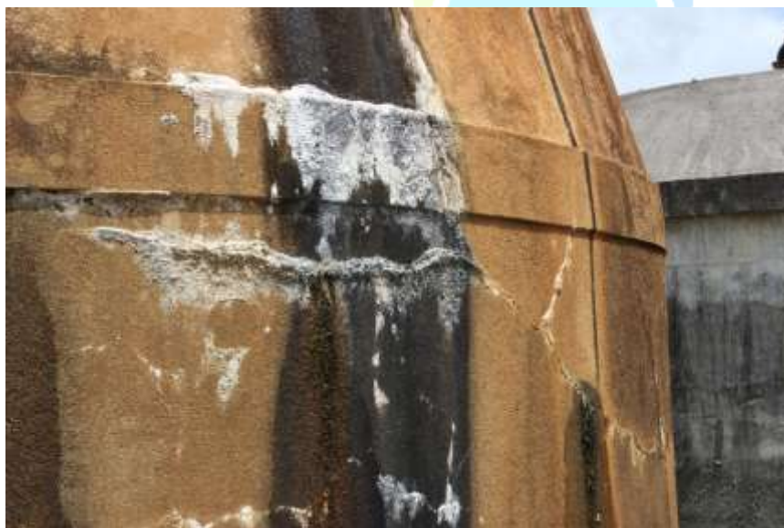
Figura 3. Manchas de carbonatação
