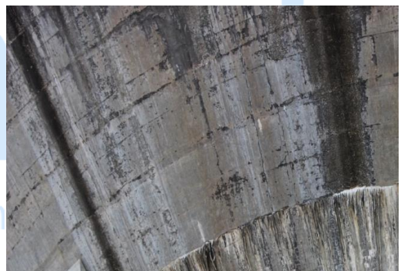
Figura 6. Machas de vazamento
