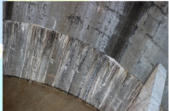
Figura 4. Carbonatação nas paredes
