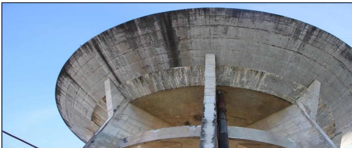
Figura 8. Vazamentos nas paredes do reservatório
