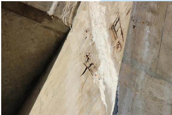
Figura 3. Exposição da armadura no pilar
