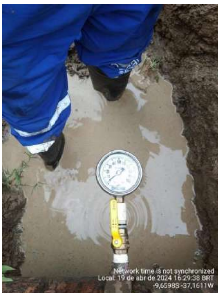
Figura 4 - Pressão manométrica de 3 mca, verificada pela unidade responsável
